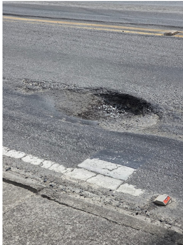
Foto 1: Buraco localizado próximo a residência nº 2922
