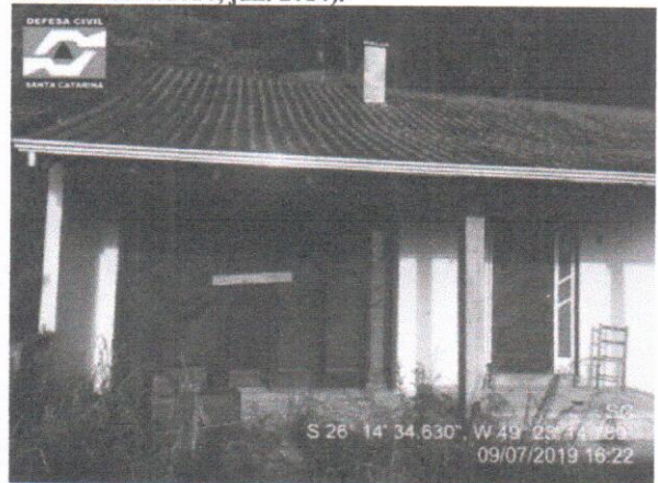
Figura 18. Edificação Unifamiliar de propriedade de Dolores R. Alves permanece interditada. (Fonte: Defesa Civil Estadual SC, 09/07/19).
