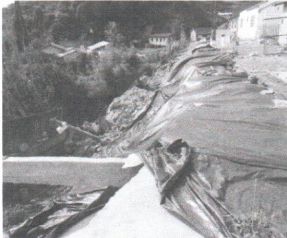
Figura 7. Com o desmoronamento do muro de arrimo e da encosta, foi atingida a área frontal ao imóvel residencial sem comprometer estrutura da edificação. (Fonte: extraído de Laudo D.C. de São Bento do Sul n.128/2014, jun. 2014).
