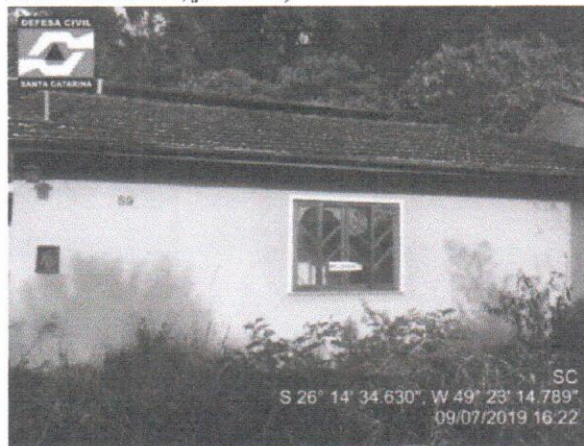
Figura 14. O imóvel residencial unifamiliar permanece interditado. (Fonte: Defesa Civil Estadual SC, 09/07/19).
