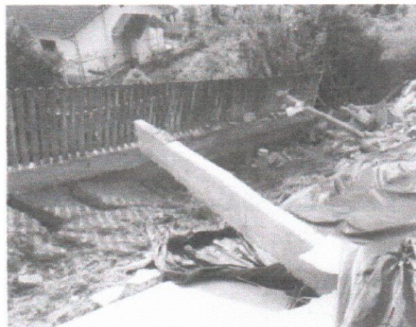
Figura 12. Com o desmoronamento do muro de arrimo que sustentava a rua também atingiu o muro frontal da edificação. (Fonte: extraído de Laudo D.C. de São Bento do Sul n.128/2014, jun. 2014).
