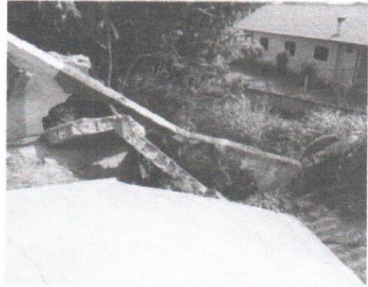
Figura 16. O desmoronamento atingiu o muro e pátio aterrado. (Fonte: extraído de Laudo D.C. de São Bento do Sul n.128/2014, jun. 2014).
