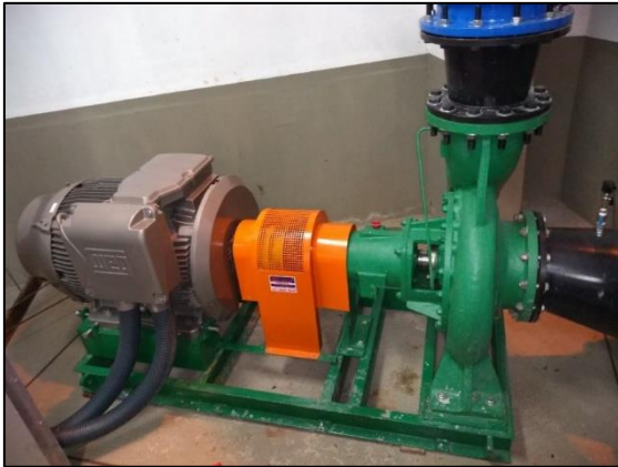
FIGURA 18 – BOMBAS DE RECALQUE DE ÁGUA BRUTA.
