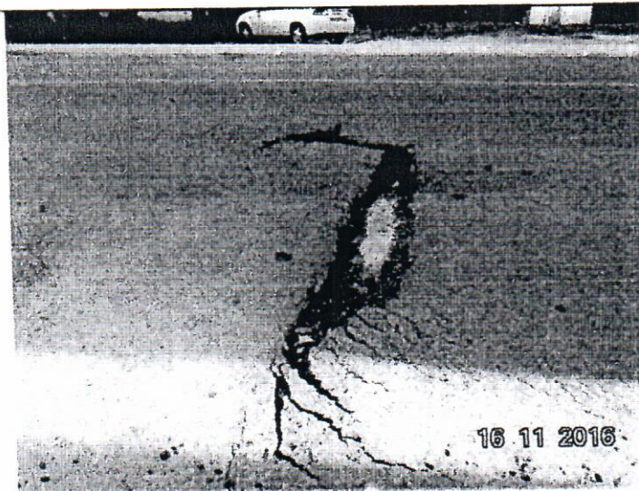
Deslocamento de massa asfáltica em frente à residência nº 1646
