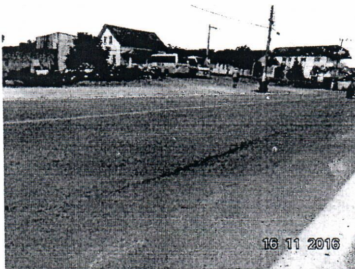
Trinca longitudinal em frente à residência nº 1564
