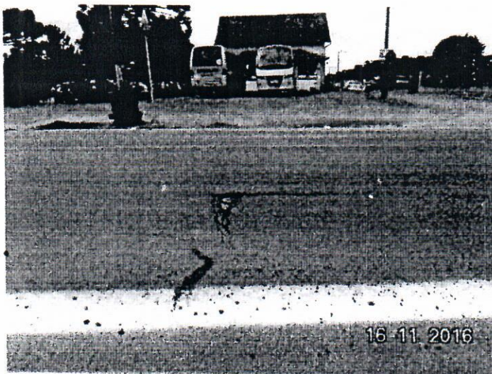
Deslocamento de massa asfáltica em frente à residência nº 1576
