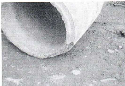
Foto 1 – Tubo danificado no descarrego
