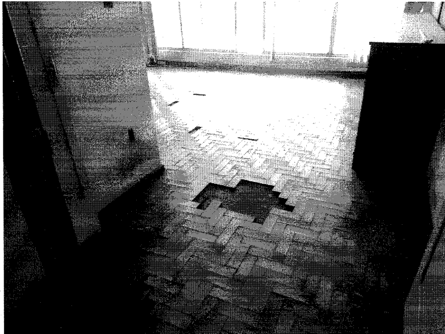
Foto 8: Piso taco de madeira danificado e faltante.
