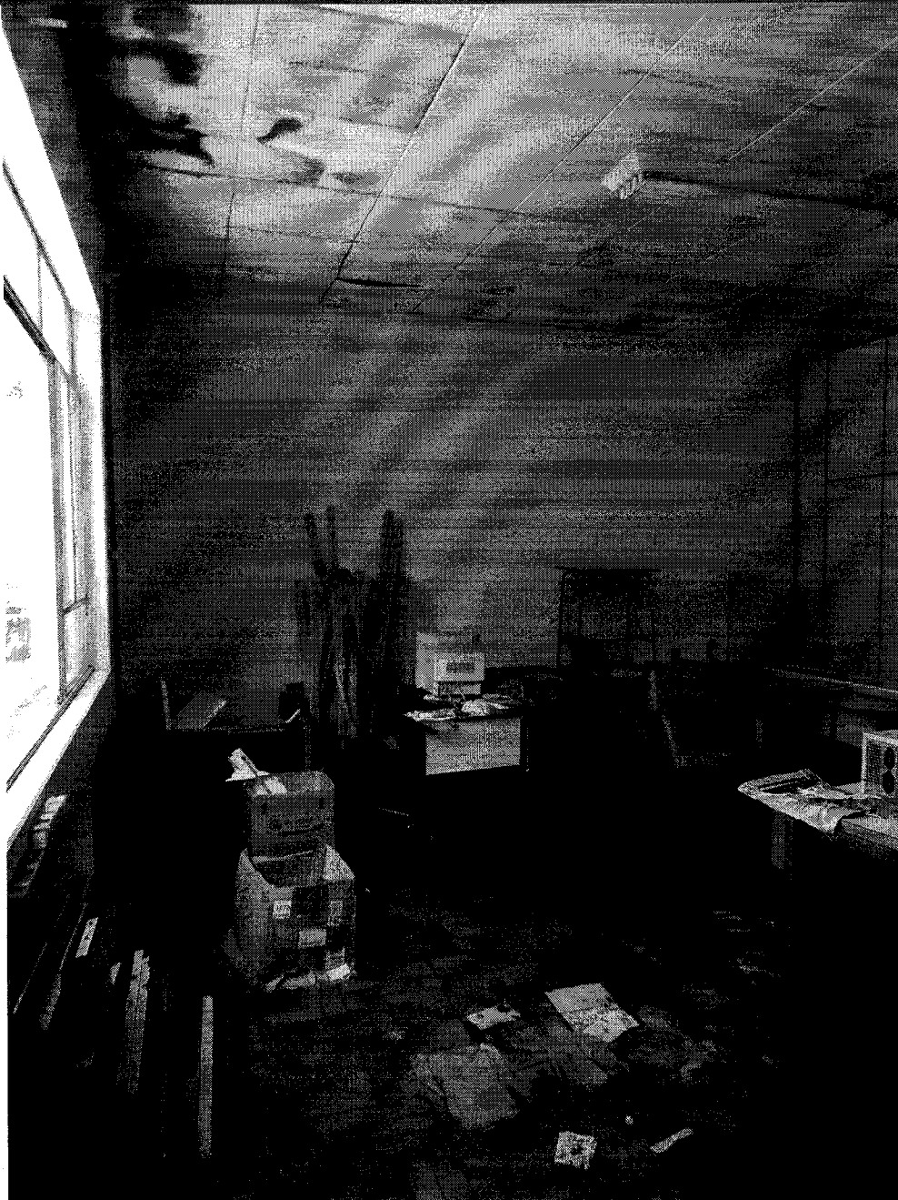
Foto 15: Forro e piso danificados.
