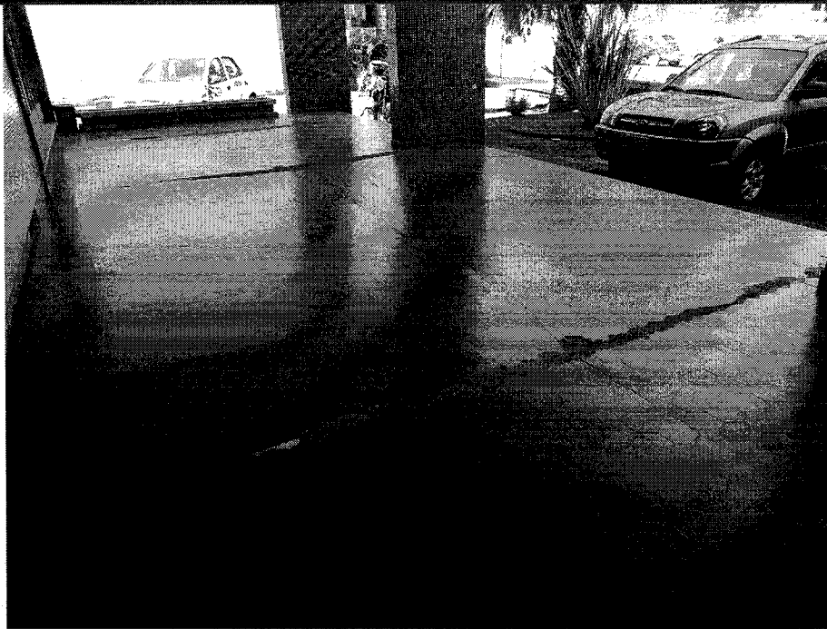
Foto 7: Piso rachado e contrapiso que cedeu.
