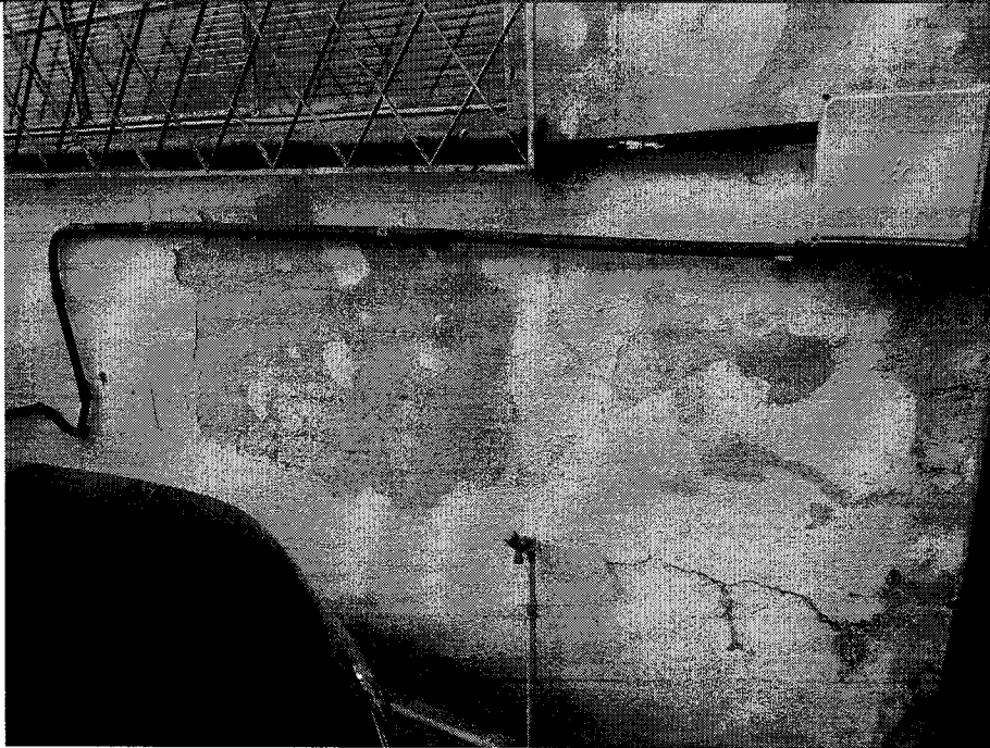
Foto 5: Reboco e pintura danificados.
