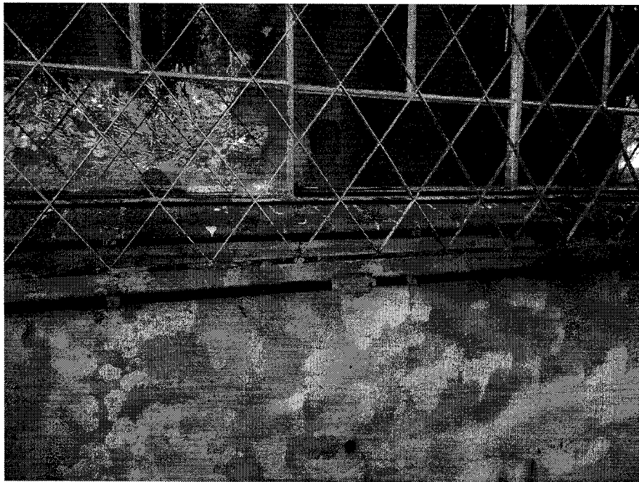
Foto 6: Esquadria com corrosão.
